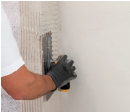
Nach Überschleifen der Platten: Kleber auftragen und Textilglasgitter einbetten (Überlappung mindestens 10 cm).
